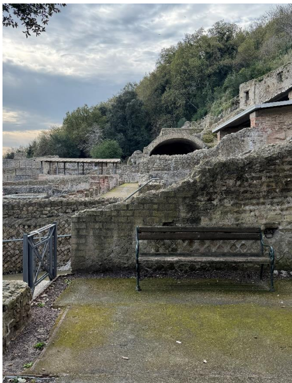
Figura 8 – Porzione di muro ricostruita, da demolire nel progetto PNRR
